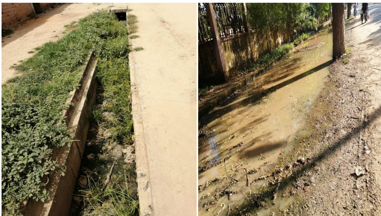
P Photo 6: Caniveaux bouchés dans la ville/ absence de caniveau sur l'axe Mairie-centre-ville
