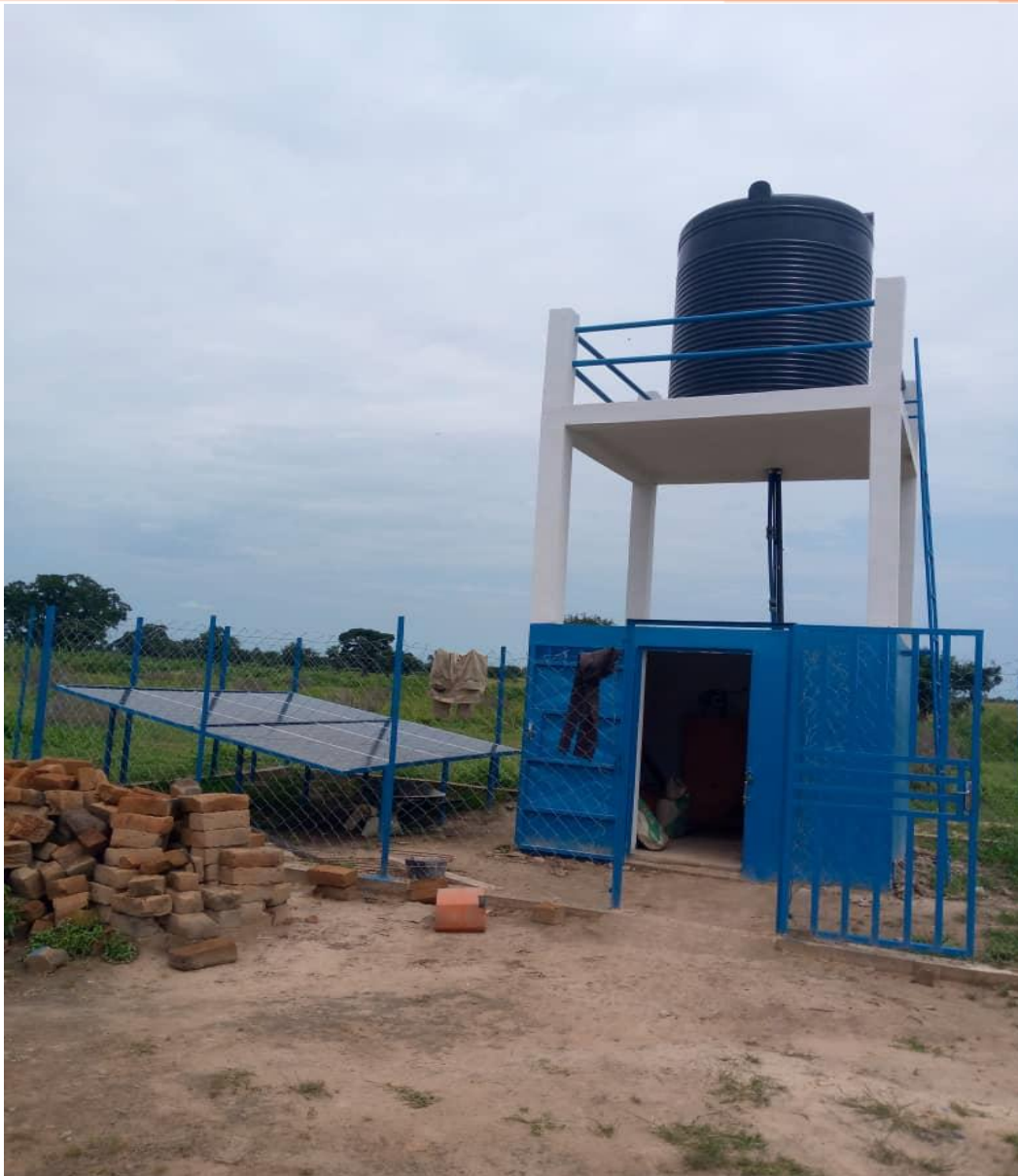
Photo 9: Forage alimenté de plaques solaires au village Tcherfeke
